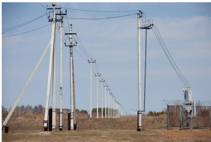
Рис. 1. Распределительные сети 10 кВ
