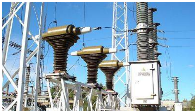
Рис. 5. Цифровые трансформаторы тока
