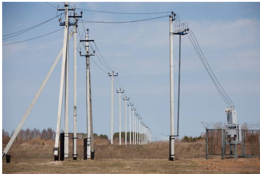
Рис. 1. Распределительные сети 10 кВ
