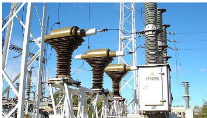
Рис. 5. Цифровые трансформаторы тока
